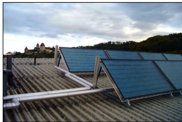
Solaranlage auf Schulanlage Schlosmatt, Burgdorf
